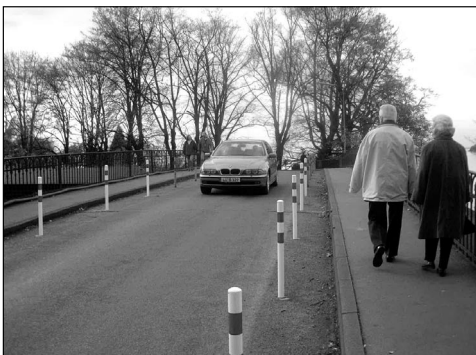
Eine der Gefahrenstellen: Die „ertüchtigte“ Thierschbrücke
